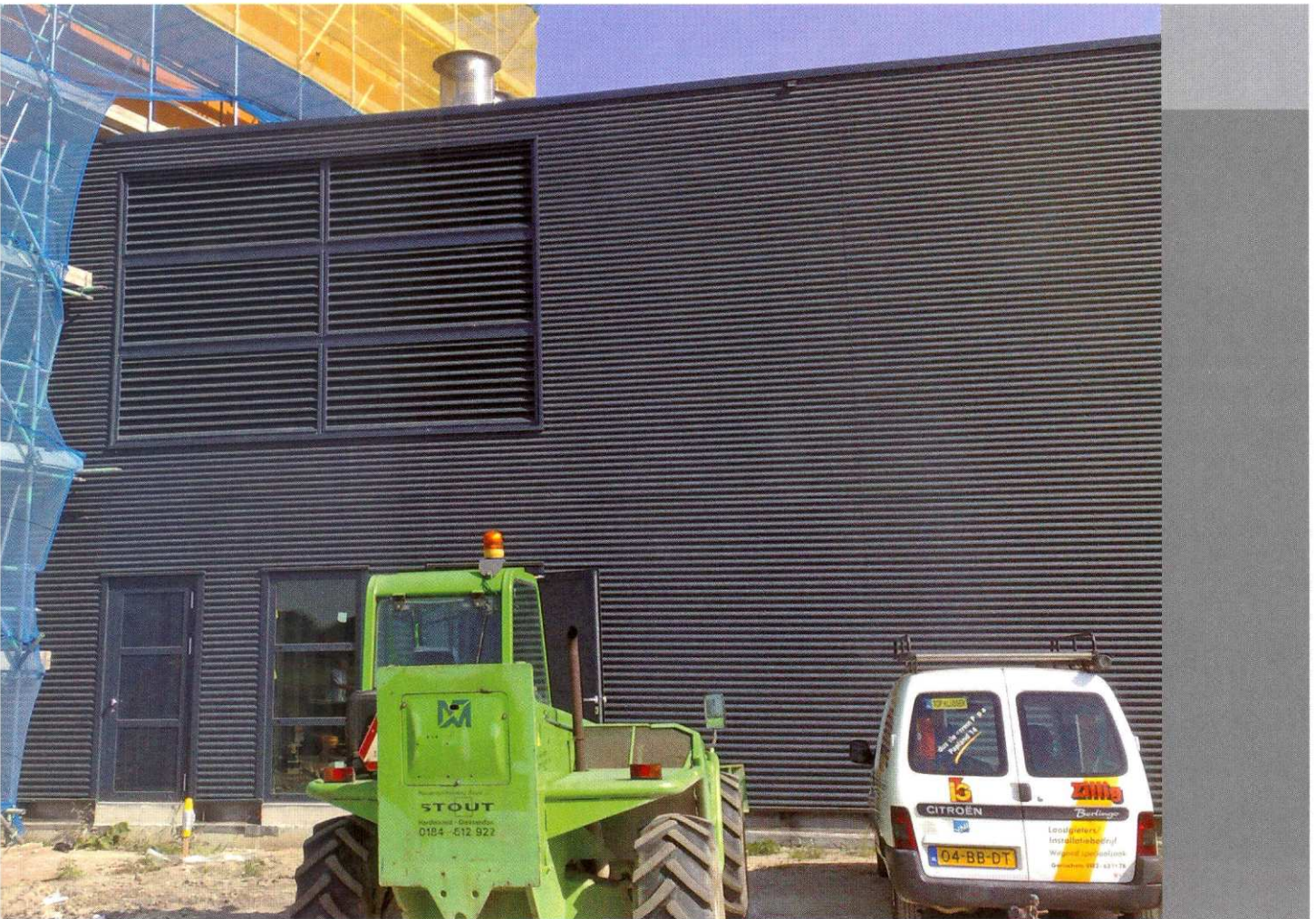
Alleen roosters verraden de aanwezigheid van de installatieapparatuur
