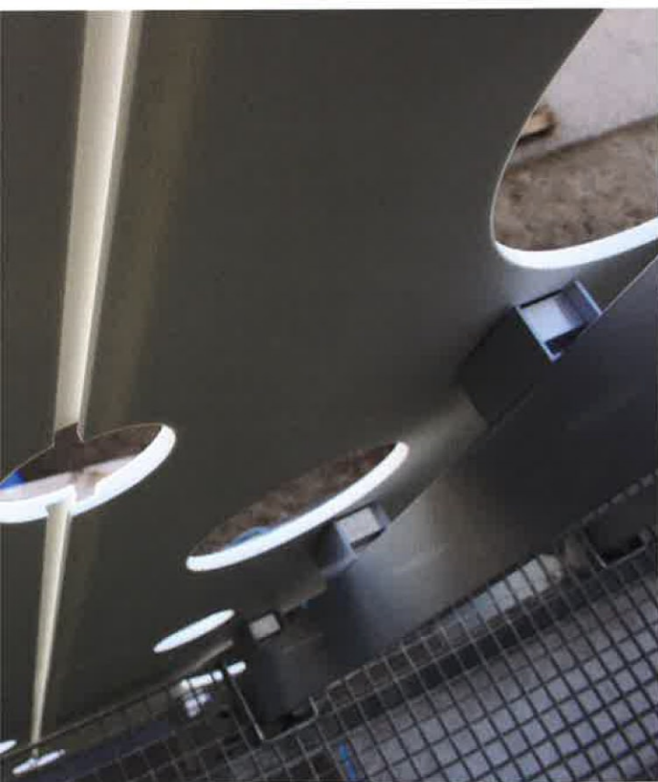
Het Corian is strak uitgelijnd, met een halfhoutse aansluiting in de verticale naden.
